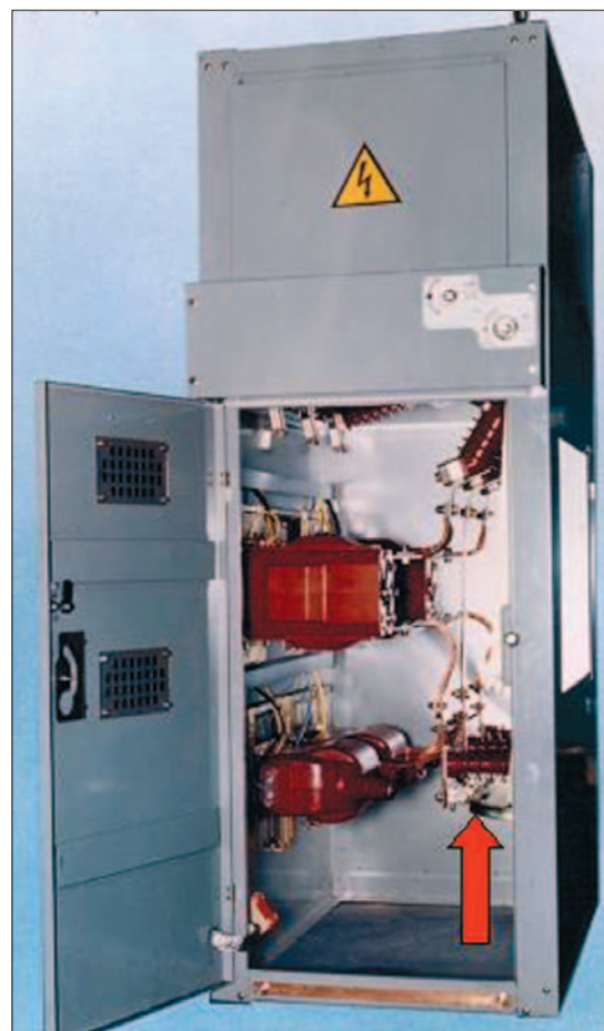
Fig. 1 Punto di prelievo (consegna) della fornitura d'energia secondo l'unificazione Enel (doc. DK 5600 ed. IV 3-2004). Quadro MT - fonte Enel
